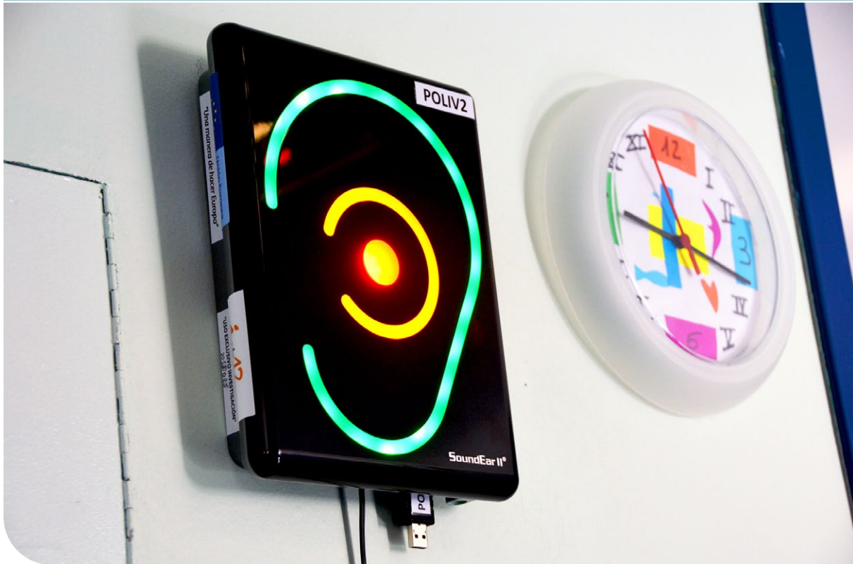
Figura 15. Medidor acústico instalado en una UC 16
